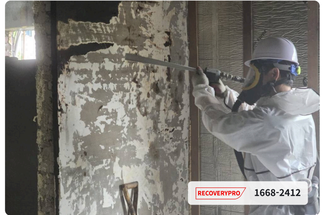
화재 현장 — 손상 마감재 철거 및 탄화층 제거
